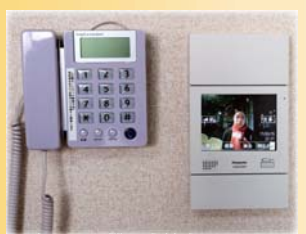
左の電話機は内線専用電話 2LDKのファミリーマンションは 一部ついていない棟があります
